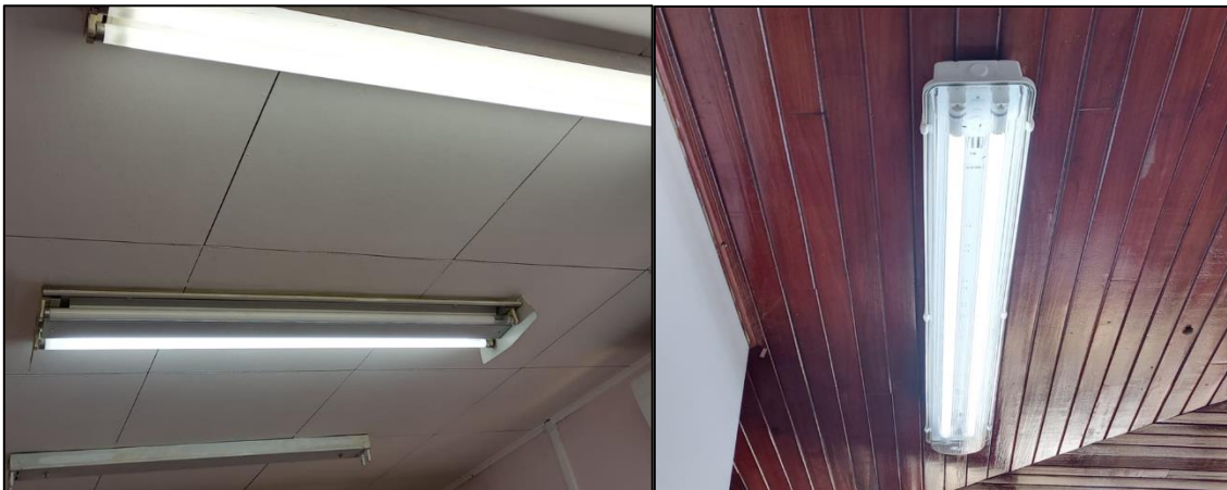
Anexo 5. Iluminaria fluorescente.
